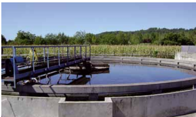
Bassin de clarification au Passage-d'Agen
