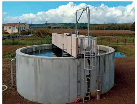
Bassin d'épuration de l'usine d'eau potable de Sérignac.
